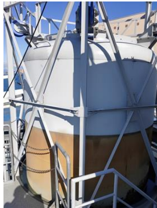
バイオガス回収タンク
