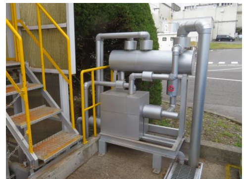
汚泥乾燥機の廃熱回収
