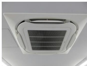
代替フロンを使用した空調設備
