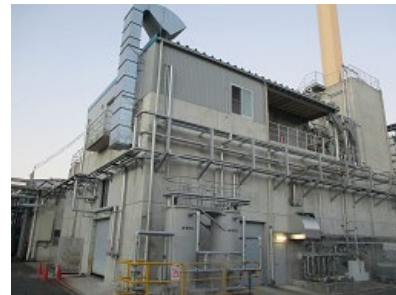
廃水処理設備 (名古屋工場)
