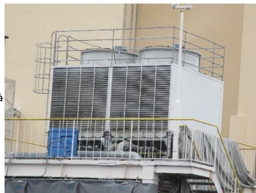
クーリングタワー洗浄 による効率改善
