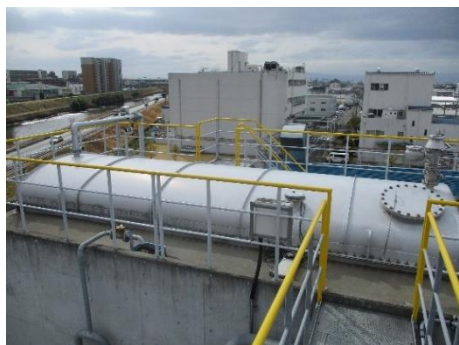
廃水処理設備 嫌気処理槽
