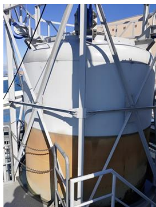
バイオガス回収タンク
