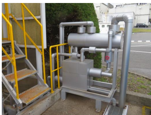
汚泥乾燥機の廃熱回収
