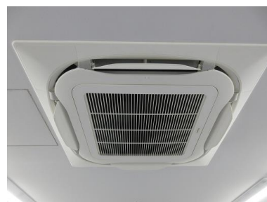
代替フロンを使用した空調設備
