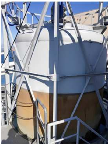
廃水処理設備 バイオガス回収タンク (名古屋工場)
