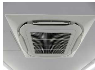
代替フロンを使用した空調設備
