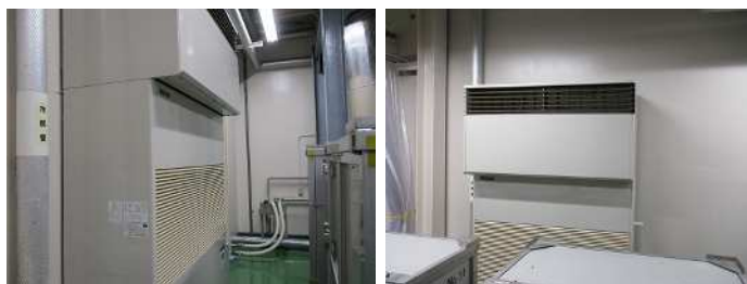
代替フロンを使用した空調設備
