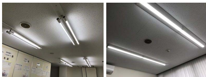
事務所・工場内照明のLED化
