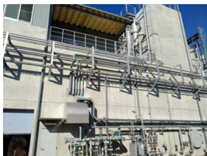
導入した廃水処理設備 (名古屋工場)
