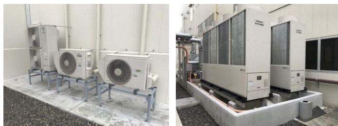
代替フロンを使用した冷却設備
