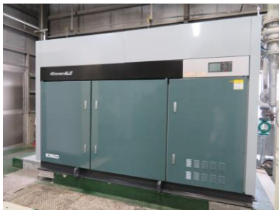
高効率空気圧縮機（養老工場）
